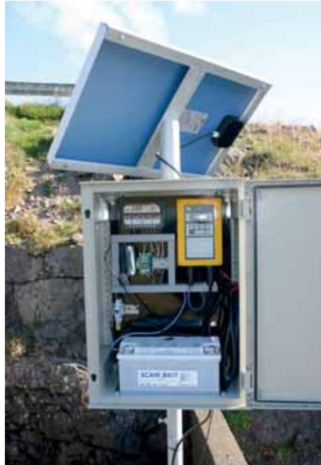
Kuva 2. Vaki-laskurin ohjausyksikkö, joka on kytketty toimimaan aurinkopaneelin lataamalla 12 voltin akulla. Kuvassa olevassa laitteessa on asennettuna myös modeemiyksikkö, jonka avulla laskurin tallentamat tiedot voidaan purkaa verkkoyhteyden kautta käymättä itse laitteella. Kuva: Vaki Aquaculture Systems Ltd.
